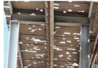
Ein durch Hagelschlag zerstörtes Metall-dach. BILD: DPA
